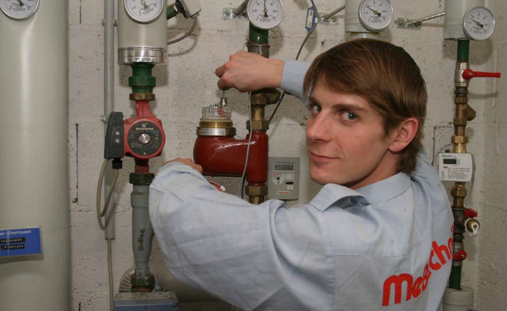
Zusätzlich zu den 4-mal jährlich von der Meßtechnik durchgeführten Zäblerservices überprüfen und kontrollieren in der heizfreien Zeit qualifizierte Meßtechnik-Fachmitarbeiter alle Wärmeeinheiten der meine-heimat Wohnanlagen.
